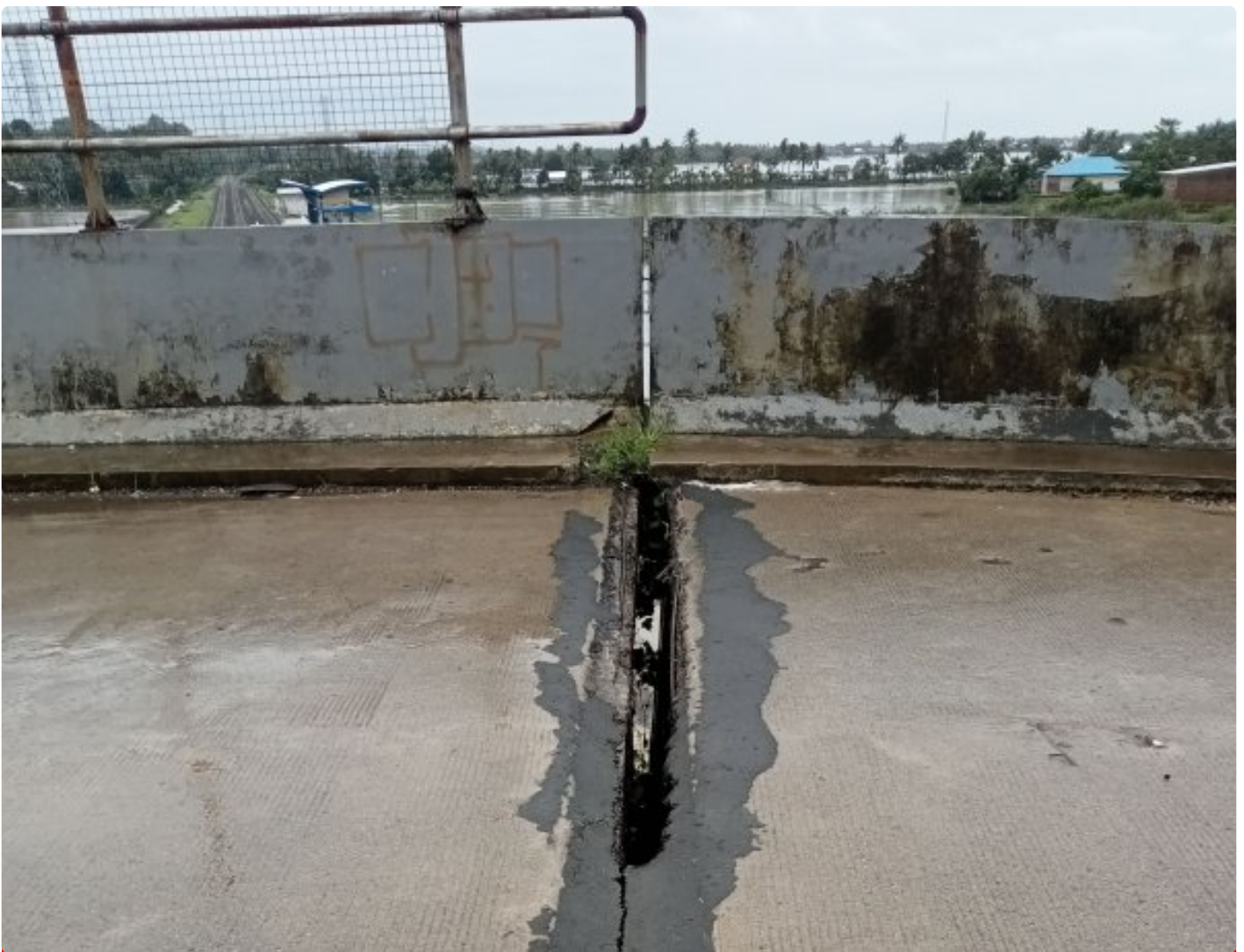
Sambungan jalan fly over Pekkae rusak parah
