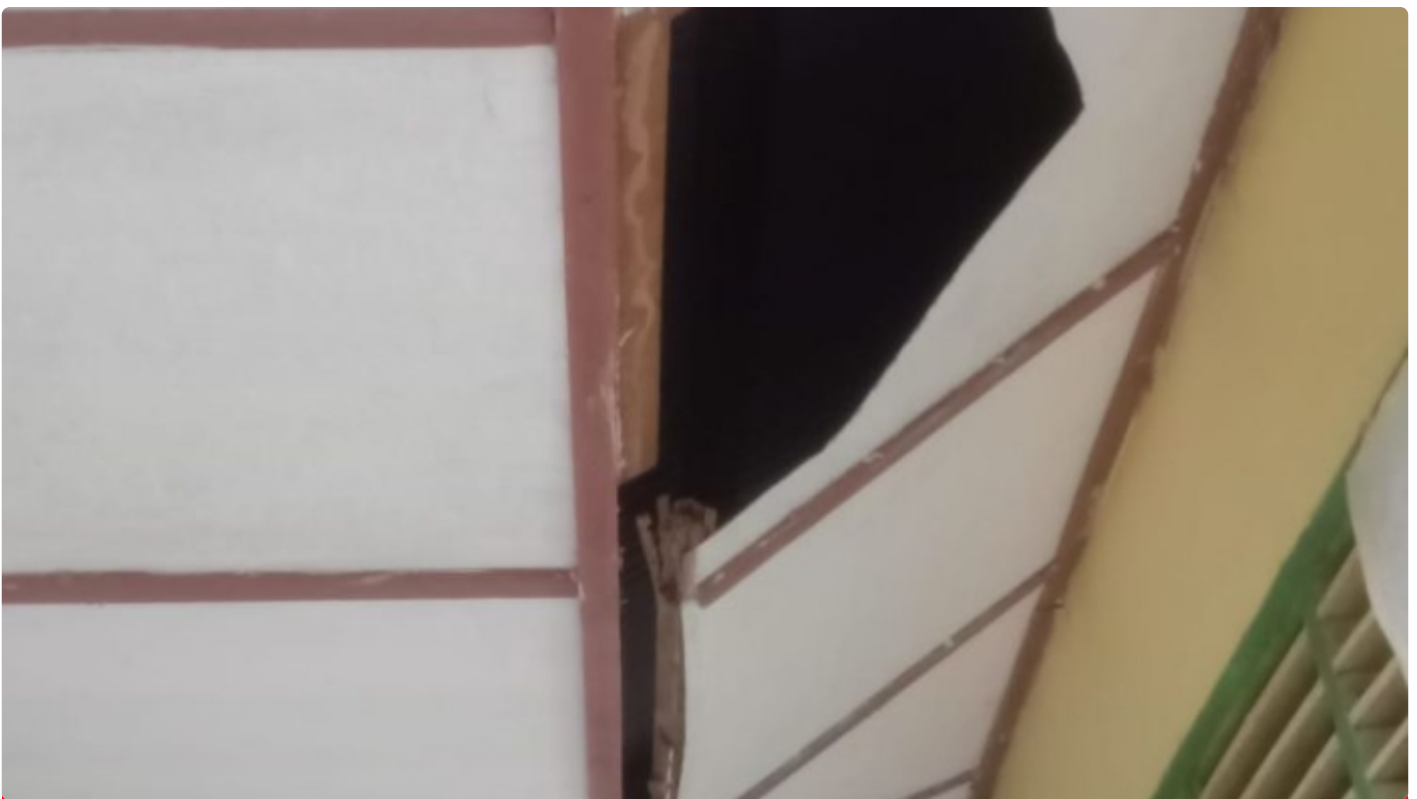
Foto: Plafon ruangan kelas UPTD SDN 67 yang rusak akibat angin kencang
